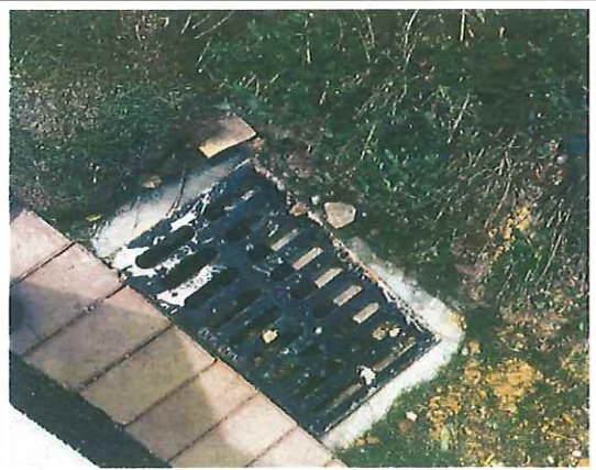
道路广场区雨水井
