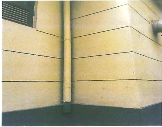
建筑物区雨水管
